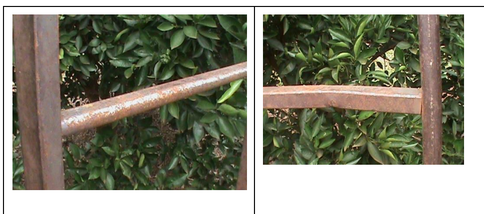
Figura 55. Degrau deformado devido ao peso sustentado.
