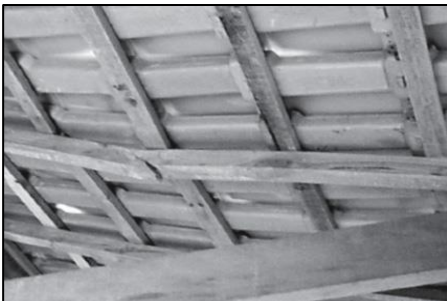
Figura 24. Viga de madeira danificada utilizada na sustentação do telhado de uma das casas construídas em 2009, de acordo com o Jornal AJIndo, 16ª edição. Fonte: AJI.
