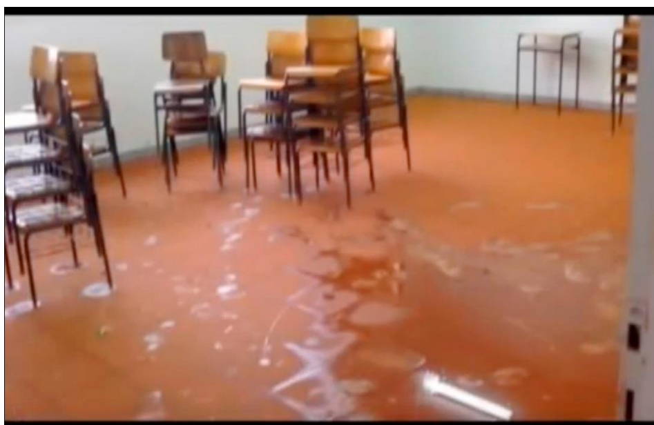
Figura 41. Sala de aula após um dia de chuva. Fonte: A.JI.
