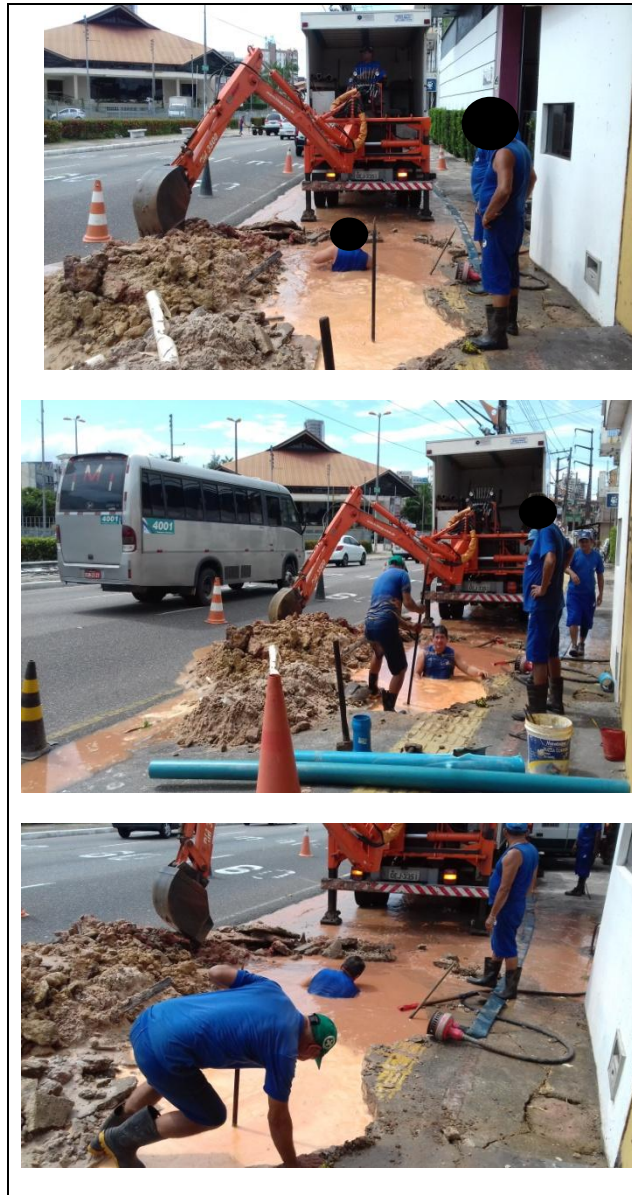
Localização da tubulação danificada
