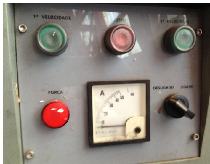
Figura B.2 – Painel de comando do equipamento Drais utilizado no trabalho.
