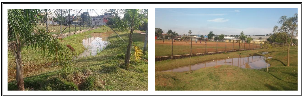
Figura 34 e 35. Fotos das bacias de retenção, após chuva do dia anterior. Fonte: AUTORA (2017).
