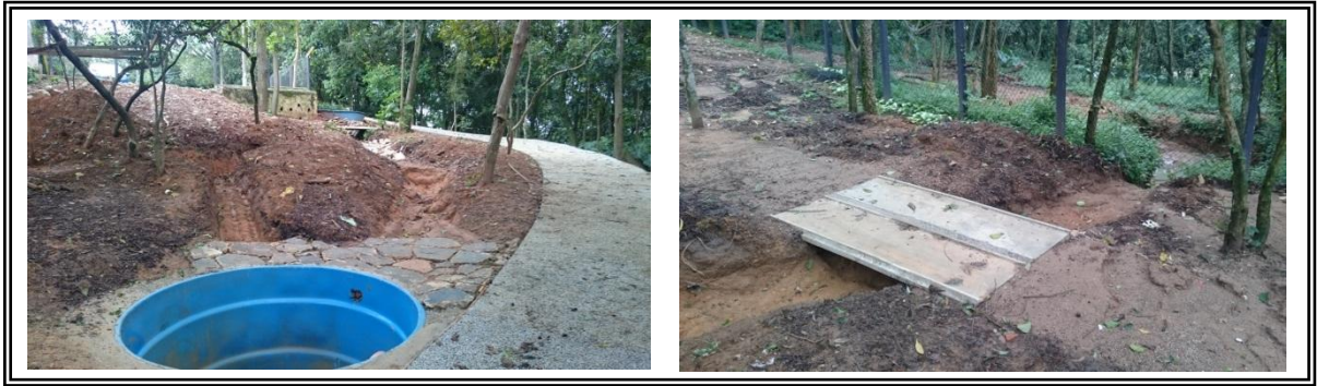
Figura 40 e 41. Fotos das valetas para condução, desaceleração e infiltração da água de chuva – TC ParCão. Fonte: AUTORA (2016).
