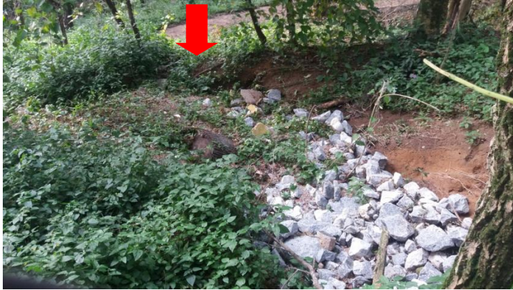
Figura 55. Foto da estrutura 3 – TC ParCão, com indicação do ponto de rompimento da estrutura e de extravasão. Presença de rachão vindo com o escoamento superficial. Fonte: AUTORA, 2018.
