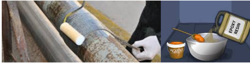
FIGURA 1 - Revestimento de superfície metálica. (1.13)
