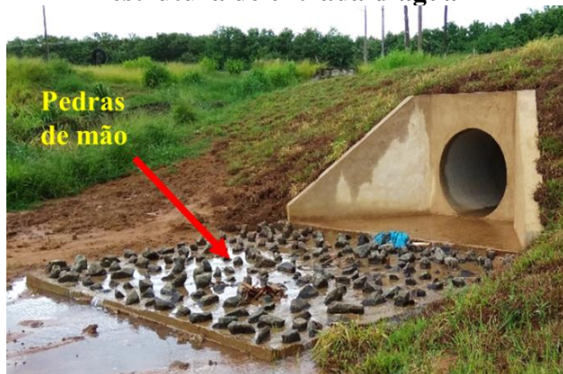
Figura 114 – Disposição de rochas na estrutura de entrada d'água
