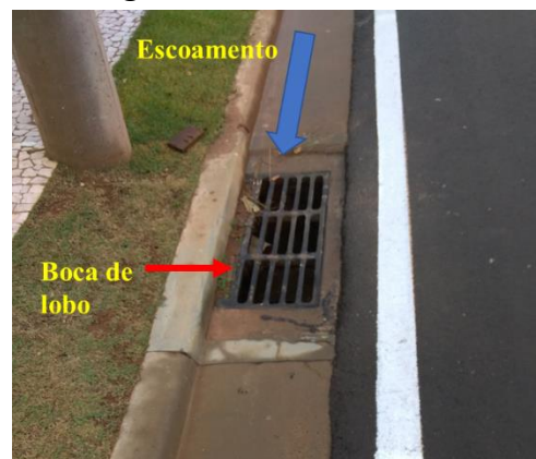
Figura 41– Boca de lobo
