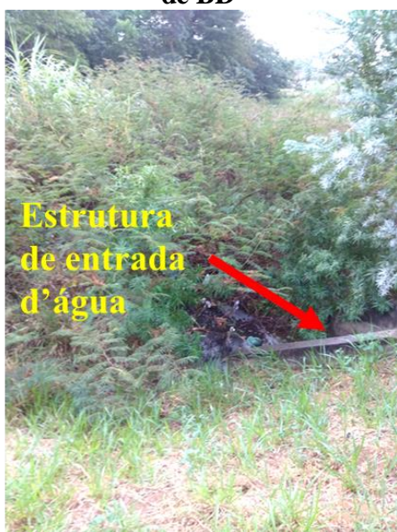
Figura 127 – Vegetação excessiva dentro de BD
