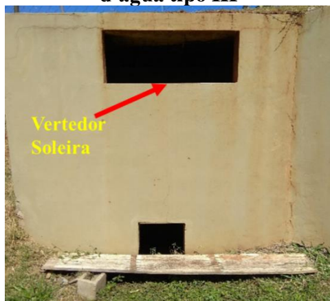
Figura 118 – Estrutura de saída d'água tipo III
