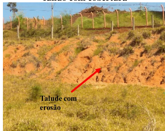
Figura 122 – Talude sem cobertura, fundo com cobertura
