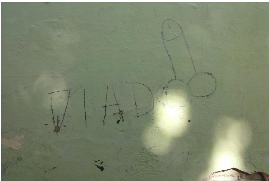
Figura 10 – Pichação em um dos “cinemões” da rua Assunção (2014).
