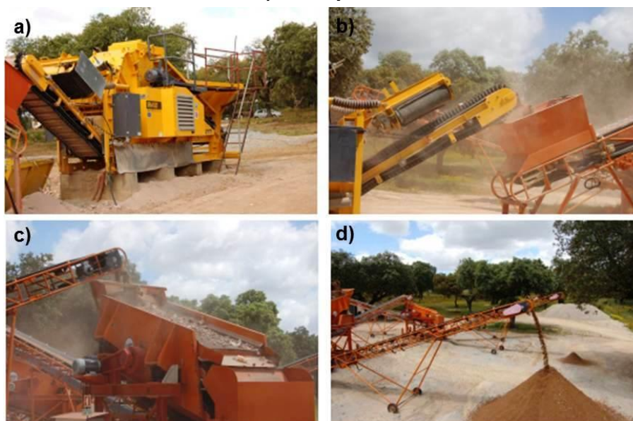
Figura 28. Unidade de reciclagem. a) Britagem, b) Separação magnética, c) Crivagem e d) Transporte.
