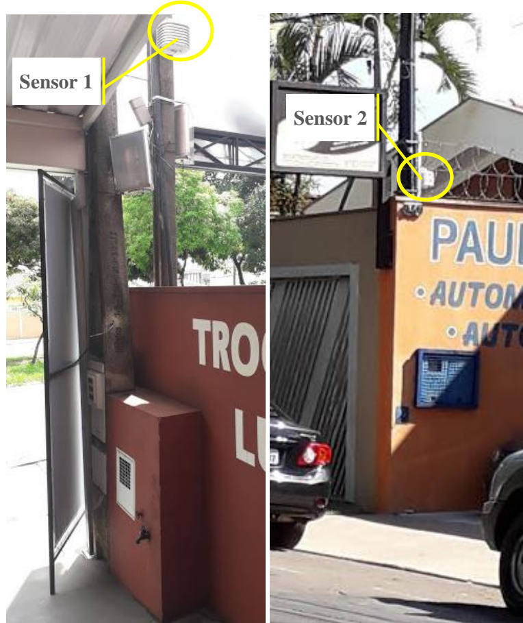
Figura 19 - a) pontos de coleta de dados no Parque Linear das Torres, b) Sensores instalados
