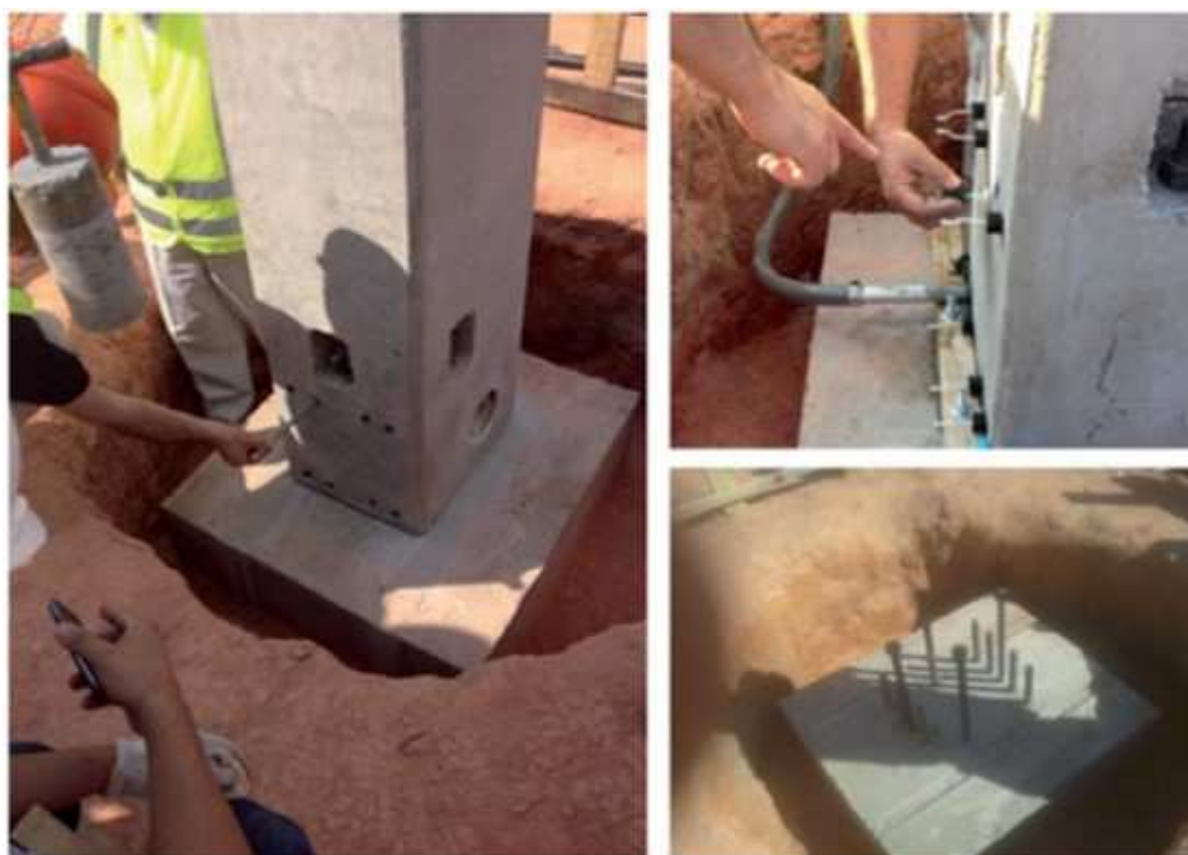
Figura 2.10: Aplicação piloto da ligação com luva mecânica grauteada tipo Splice Sleeve em pilar-fundação.
