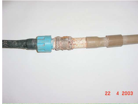
FIGURA 6.60 – Detalhe do uso de materiais fora de norma - Fonte – SABESP (2003)
