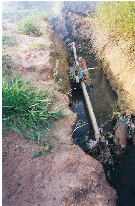
FIGURA 6.39 – Situação da rede de água após a erosão
