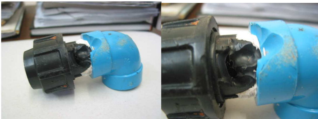
FIGURA 6.58 – Detalhe da abrasão causada pela ação da água do vazamento + solo
