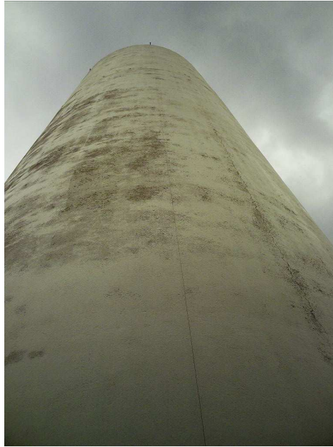
FIGURA 6.48 – Vista do cabo de aço para medição de nível no reservatório elevado
