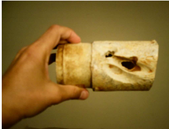
FIGURA 6.52 – Detalhe da ação abrasiva da água do vazamento associada com o solo
