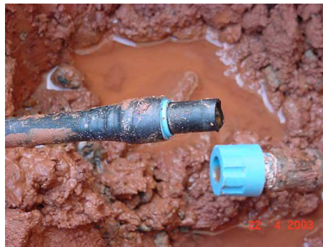
FIGURA 6.61 – Desengate da conexão pelo uso de peças indevidas. Fonte – SABESP (2003)
