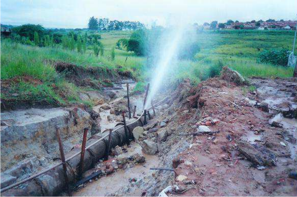
FIGURA 6.38 – Vazamento na rede de água após a erosão
