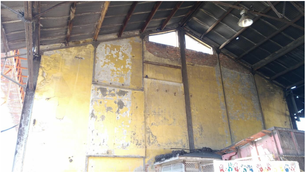
Figura 22 – Fezes de pombos amontoadas num armazém em obra. Fonte: acervo pessoal, junho de 2017.
