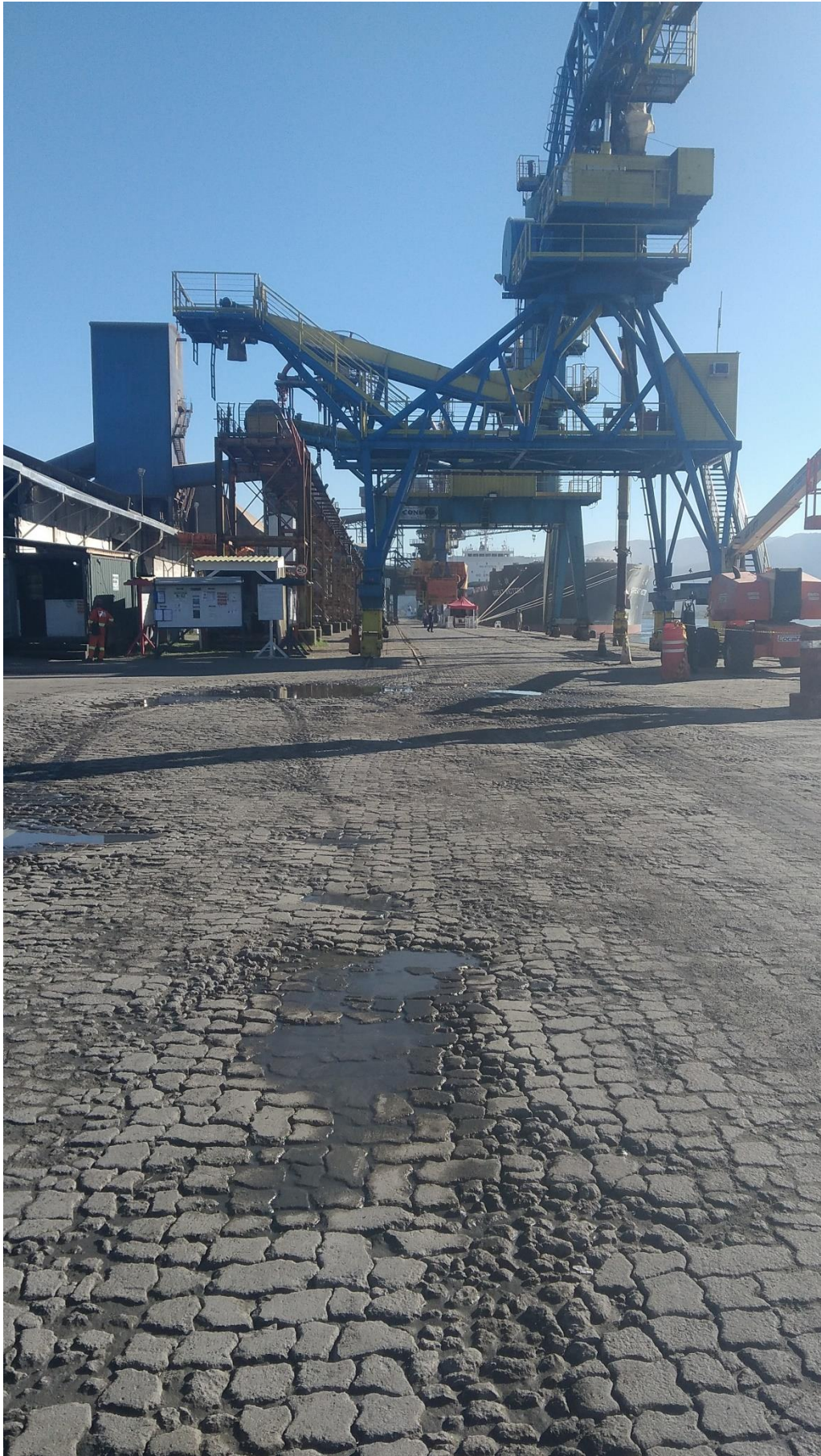
Figura 15 – Cais portuário em paralelepípedo com trechos corroídos. Fonte: acervo pessoal, junho de 2017.
