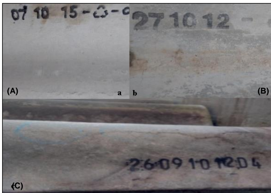
Figura 3.22 - Amostras de telhas onduladas de fibrocimento: (A) telha nova; (B) telha carbonatada; (C) telha com presença de fungos [5].
