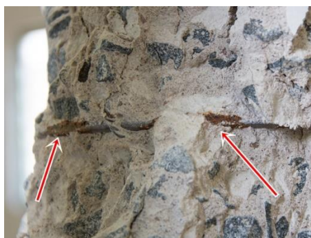
Figura 81 - Corrosão da armadura do pilar WEA_6M_0 - CP2
