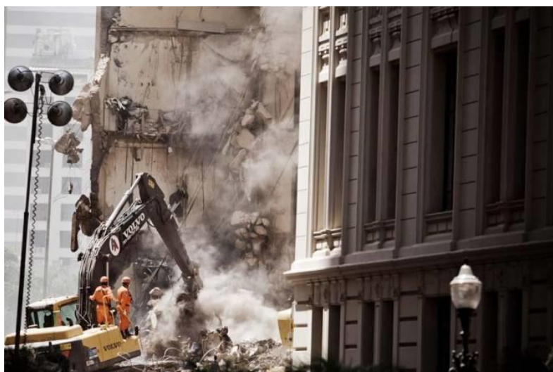
Figura 6 - Local de desabamento do edifício Liberdade, no Rio de Janeiro
