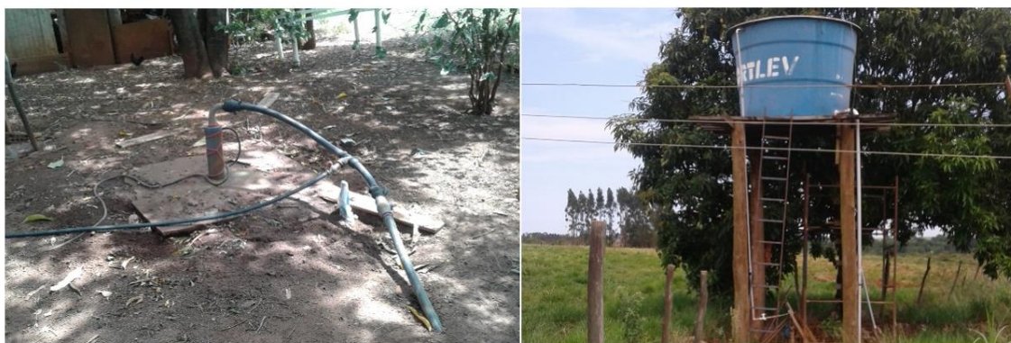
Figura 32. Captação e reservação de água comumente realizada no assentamento
