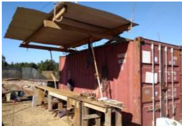
a) Contêiner tipo marítimo utilizado como área de dobra e corte de aço
