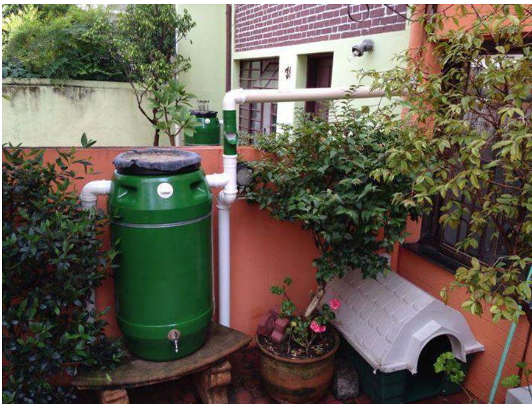
Figura 28 - Reservatório para aproveitamento de água da chuva.
