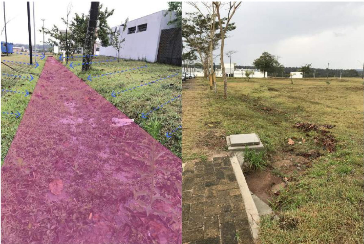
Figura 15 - Valeta de infiltração após quatro anos de sua implantação, no campus da UFSCar, em São Carlos/SP.
