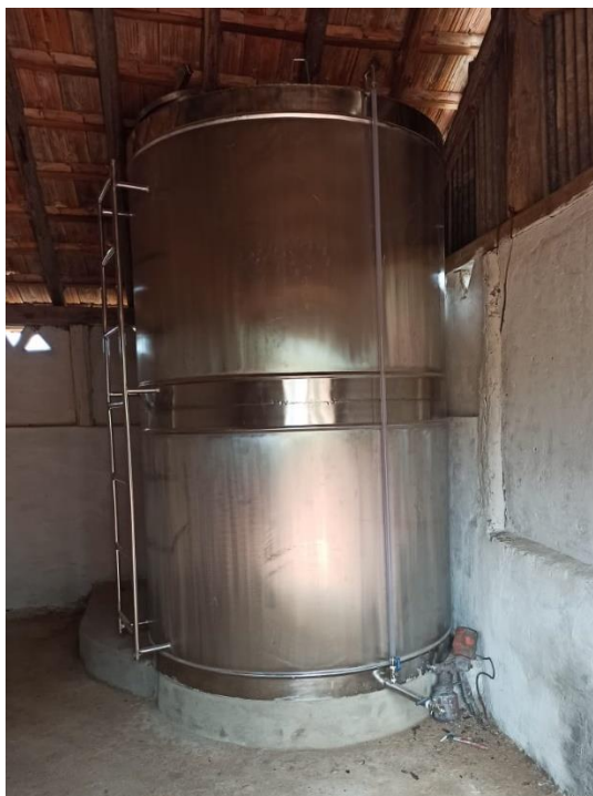
Figura 2.13: Tanque de armazenamento de aguardente
