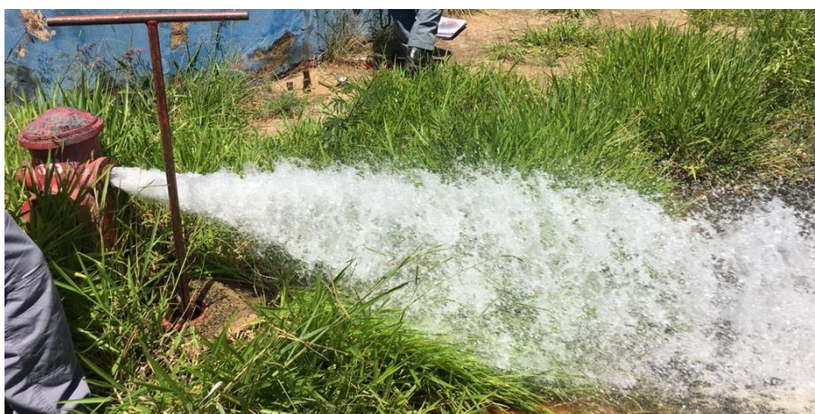
Figura 14 – Jato do hidrante de coluna nº 36
