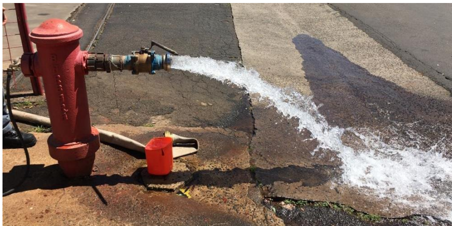
Figura 13 – Jato do hidrante de coluna nº 33
