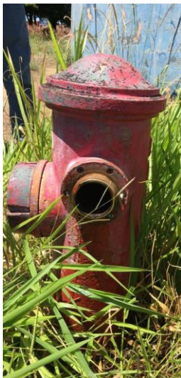
Figura 7 – Hidrante com o tampão aberto
