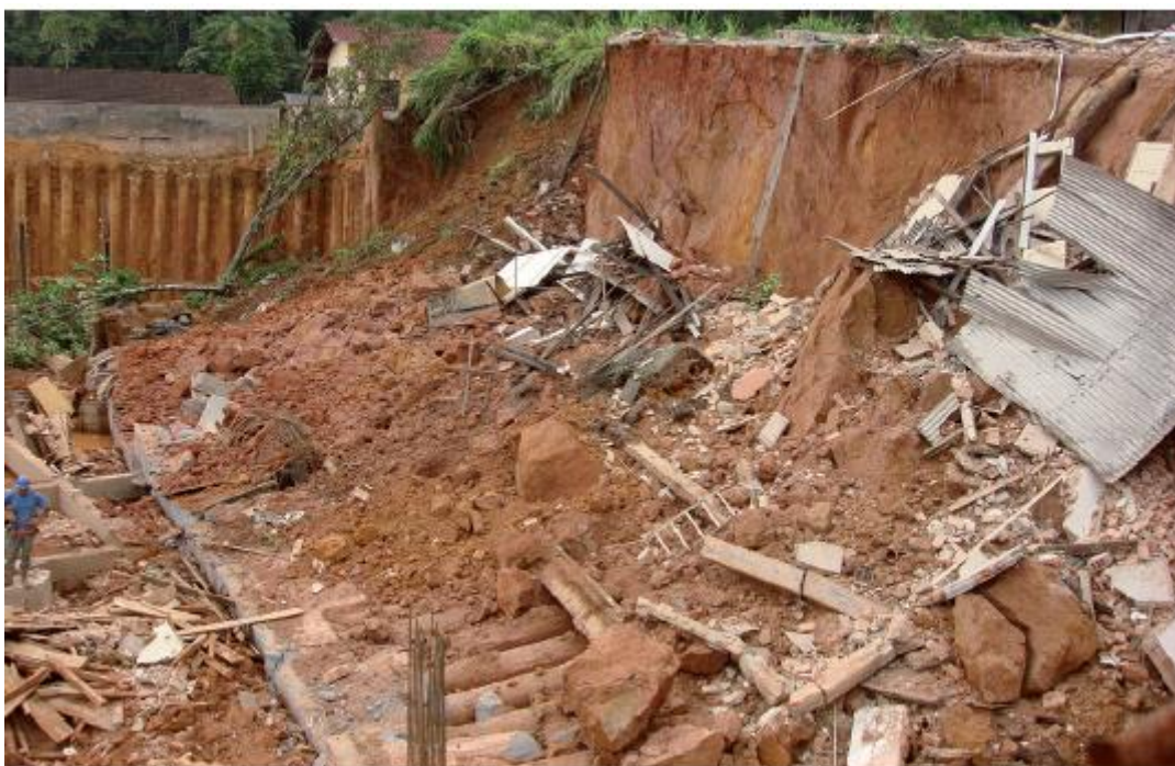
Figura 1 – Colapso de cortina atirantada de estacas
