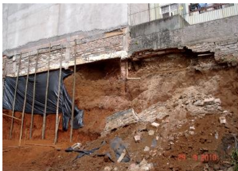
Figura 2 – Escavação não protegida provoca danos a construções vizinhas
