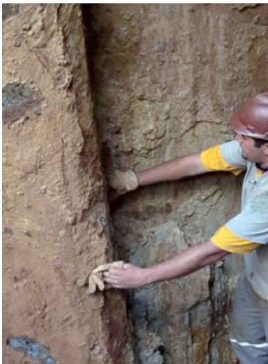
Figura 3 – Parede diafragma executada sem mureta guia resulta em lamelas descontínuas
