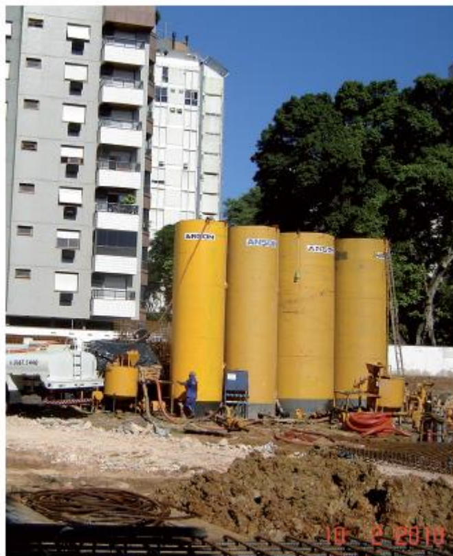
Figura 22 – Silos de armazenamento de fluido estabilizador
