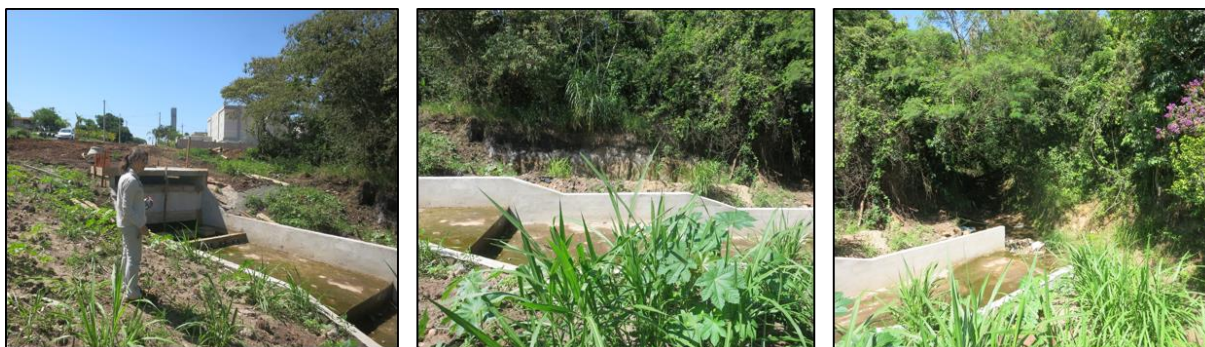
Figura 53- Obra de canalização de águas pluviais em região erodida próxima ao condomínio Parque Monte D' Oro (ponto 056), na rua João Stella do Jardim Santa Felícia. Avaliação de campo feita em fevereiro 2019 na microbacia do córrego do Mineirinho, São Carlos-SP.
