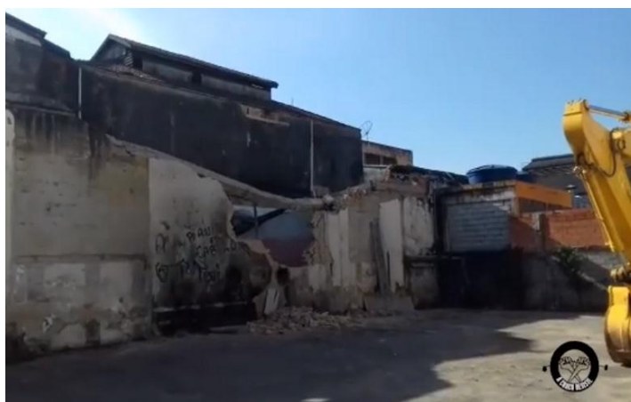
Figura 17: Escavadeira da Prefeitura atinge a estrutura de uma pensão com pessoas dentro Fonte: Fórum Aberto Mundaréu da Luz
