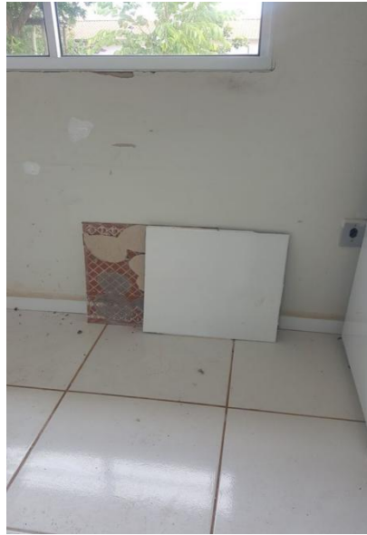
Fotografia 7: Piso solto do interior de uma das casas do condomínio Vila Dignidade de Araraquara
