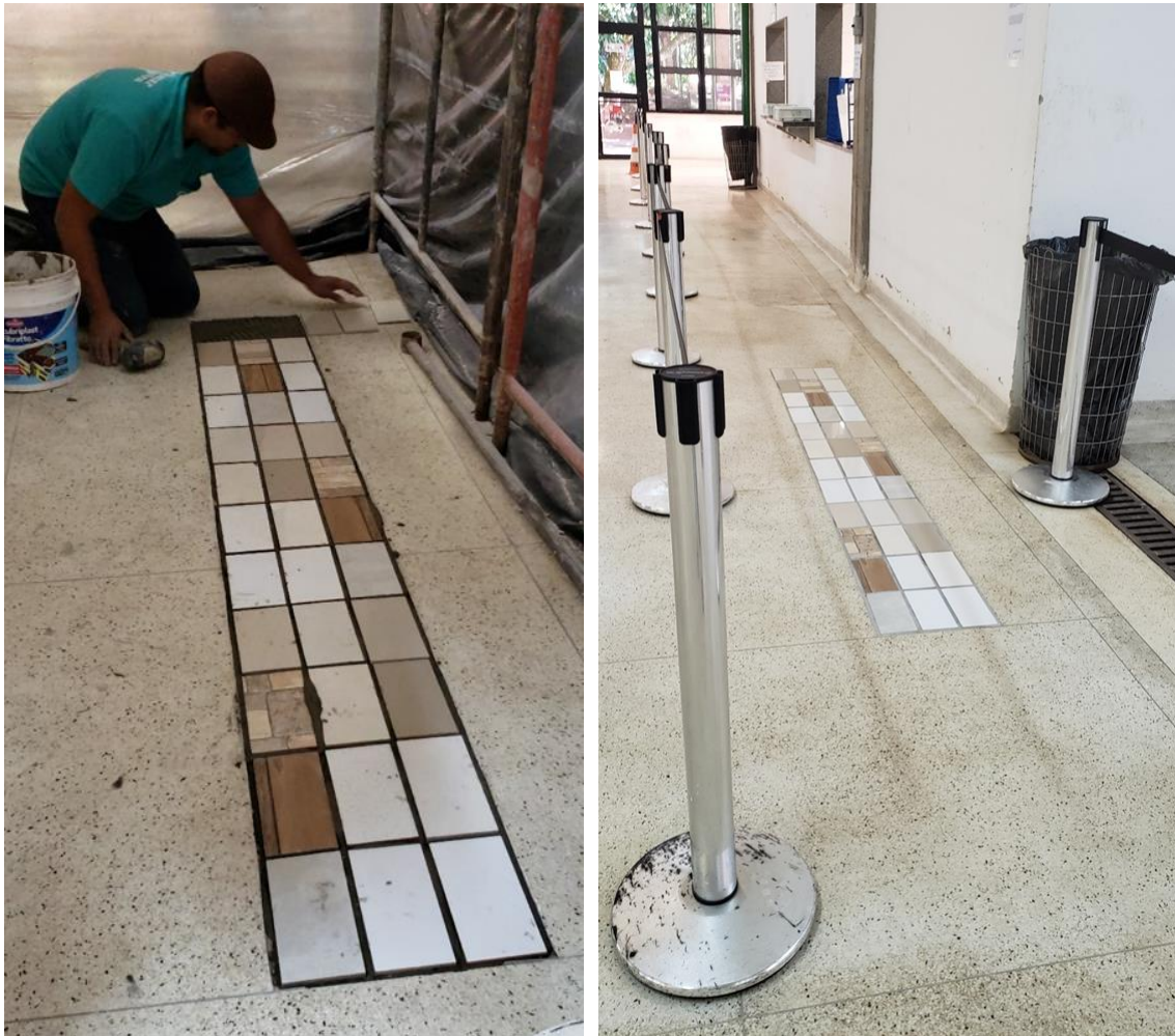
Figura 3.2 Finalização da obra e montagem do corredor projetado para centralizar e direcionar o fluxo de pedestres sobre a passarela de amostras.
