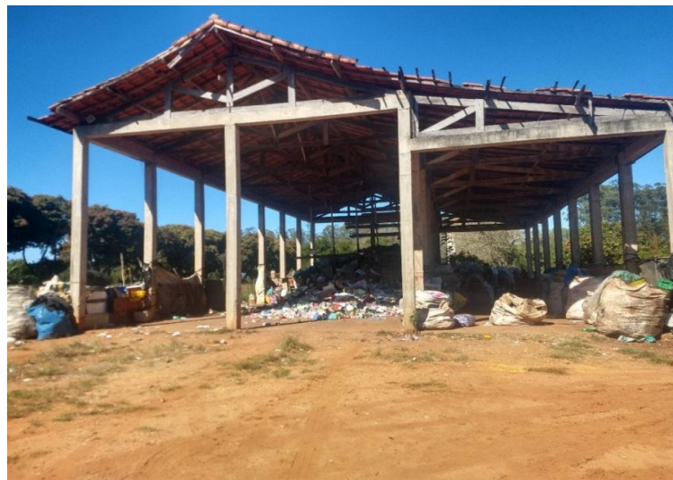
Figura 14 - Barracão de triagem dos materiais recicláveis
