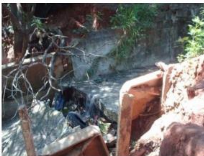
Figura 3.6 - Obra de drenagem abandonada
