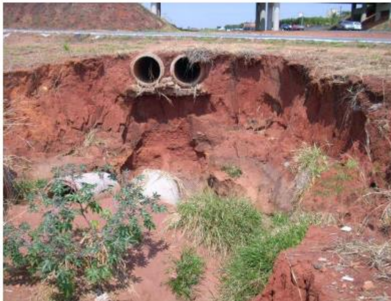
Figura 4.3 - Galeria de água pluvial inacabada
