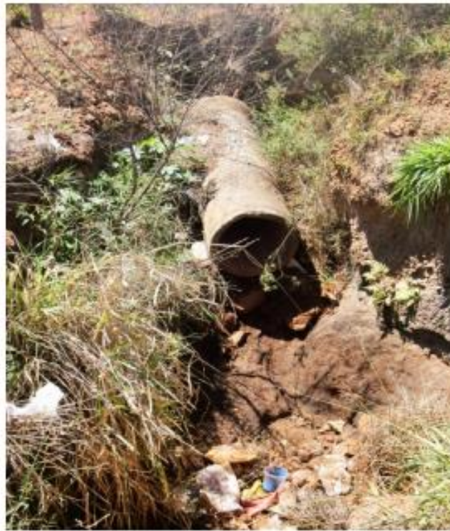
Figura 4.10 - Obra de captação de água pluvial que não suportou o volume de água
