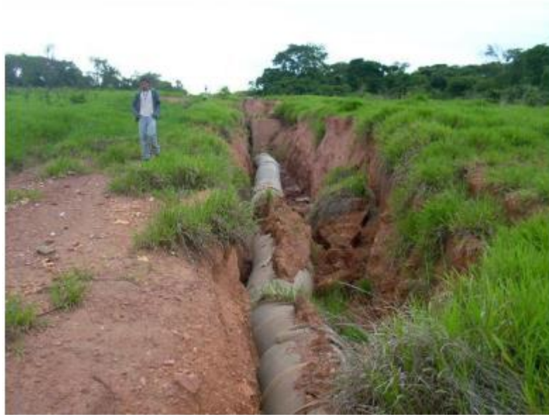
Figura 4.2 - Subdimensionamento da rede de drenagem
