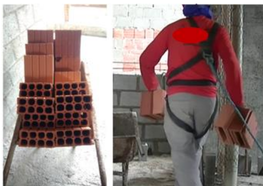
Figura 30 - Utilização do carrinho de mão para transporte e transporte manual de blocos cerâmicos
