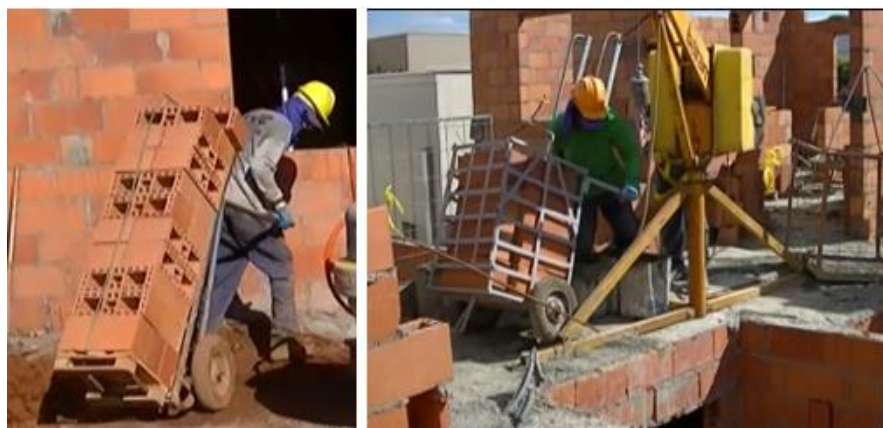
Figura 33 – (a) Transporte dos blocos da estocagem para o pavimento e (b) Transporte dos blocos no pavimento e o guincho
