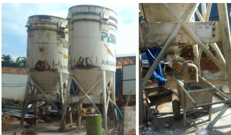
Figura 39 - Utilização dos silos no canteiro de obras para armazenamento da argamassa e do graute
