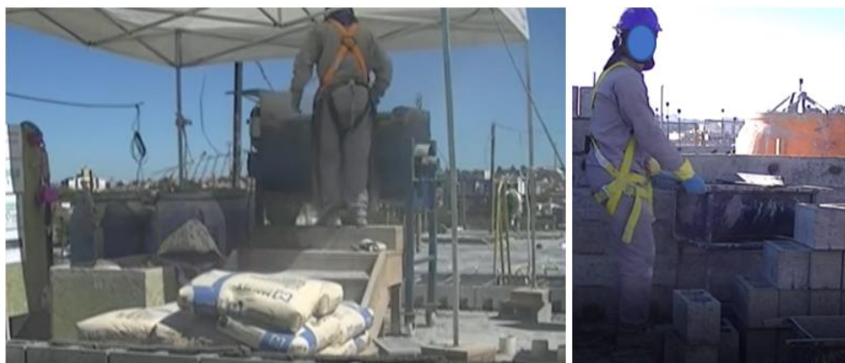
Figura 28 - Utilização da argamaseira para produção da argamassa próxima da execução da alvenaria e transporte da argamassa
