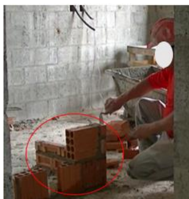
Figura 45 - Execução da elevação da parte inferior da alvenaria com dois tipos de blocos cerâmicos no AV02
