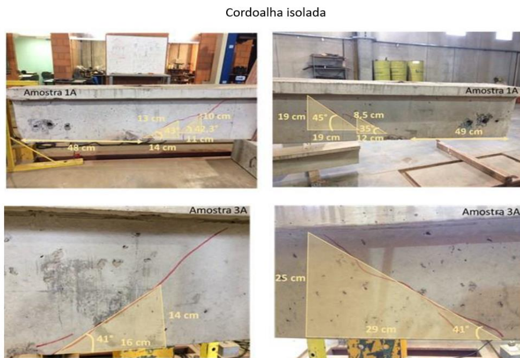
Figura 5-24:Figura 6 16: Ângulo de inclinação das fissuras das Amostras 01A e 03A (cordoalha não aderente)
