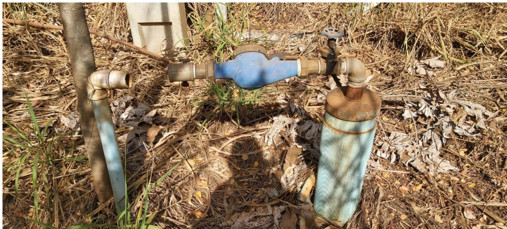
Figura 15. Poço coletivo do Núcleo Dandara.
