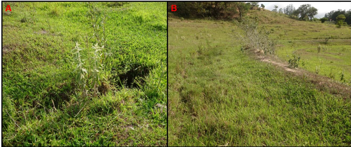
Figura 29. a) Processo erosivo no trecho 1. b) Plantas no terraço rompido.
