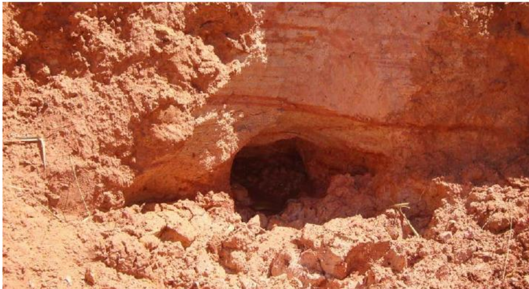
Figura 7. Piping no município de Casa Branca, São Paulo, Brasil.
