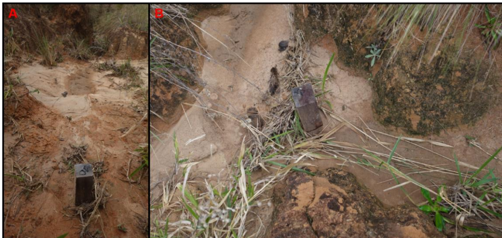
Figura 37. a) estaca 10 associada ao acúmulo de sedimento. b) estaca 12 indicando erosão do solo em seu entorno.
