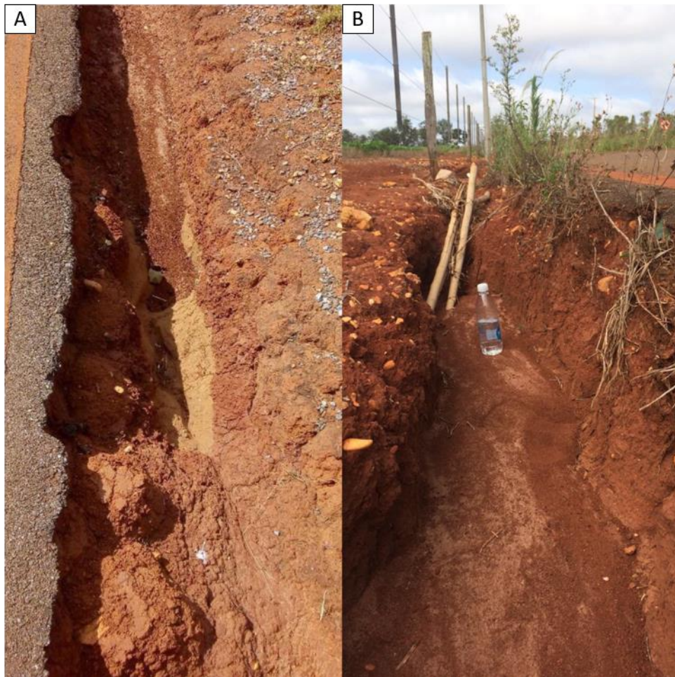
Figura 9 - Sulco identificado em paralelo à ciclovia existente na sub-bacia de estudo. Em A observa-se o trecho inicial do sulco, e em B um trecho a jusante, com maiores dimensões
