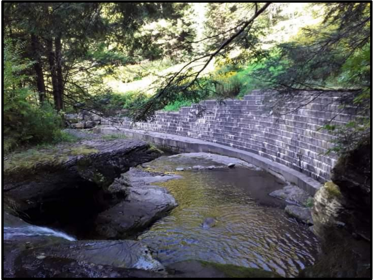
Figura 9- Gabião de contenção afluente Pepacton em Catskills
