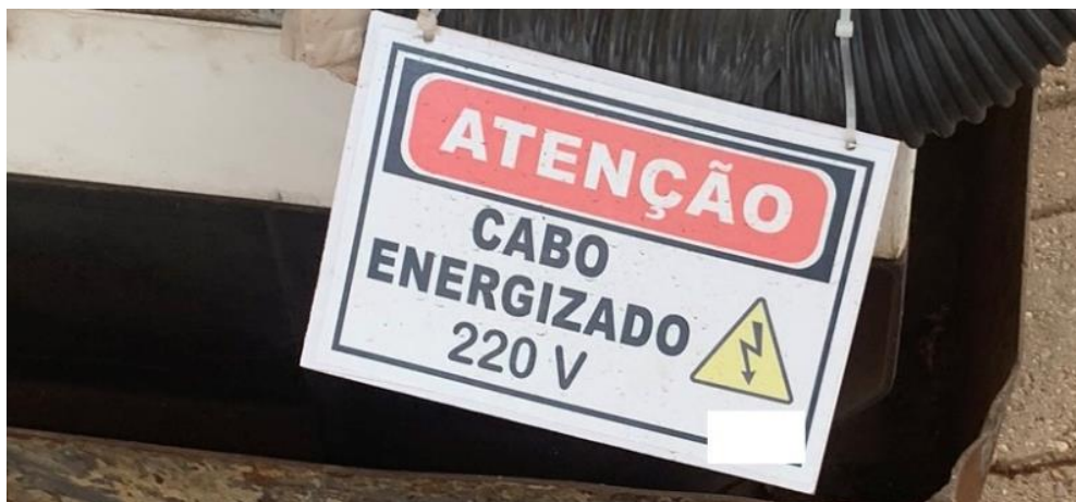
Figura 42 - Placa de atenção para comunicar perigo
