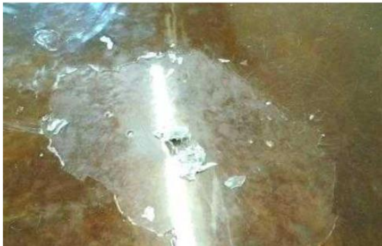
Figura 11: Porcelanato líquido com desacoplamento da camada de resina epóxi.
