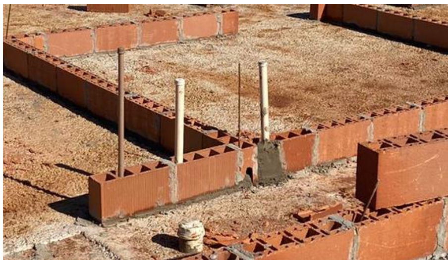
Figura 57 - Instalações hidrossanitárias alocadas nas paredes estruturais
