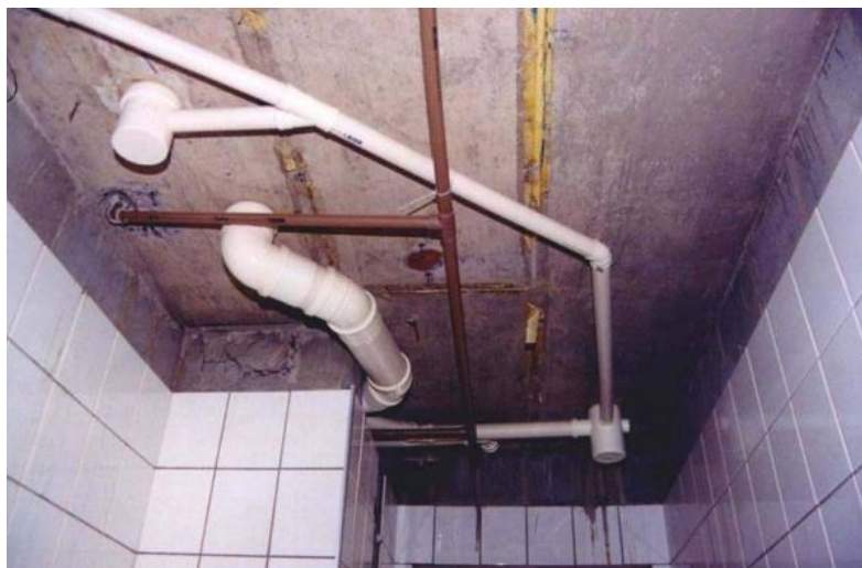
Figura 16 - Tubulação horizontal sob a laje (a ser oculta por forro de gesso)
