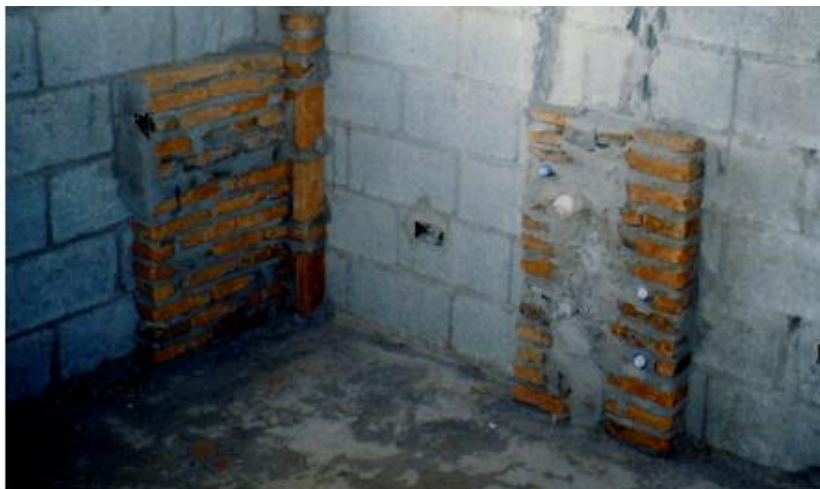
Figura 14 - Instalação hidrossanitária com enchimento de tijolos
