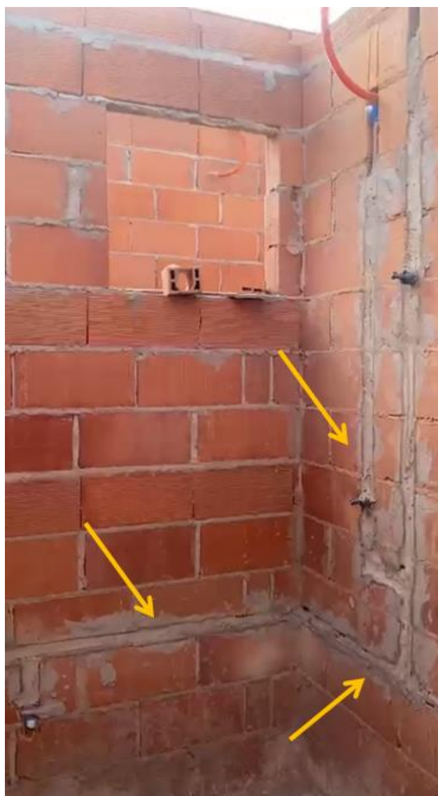
Figura 62 - Cortes nas paredes estruturais para instalações hidráulicas
