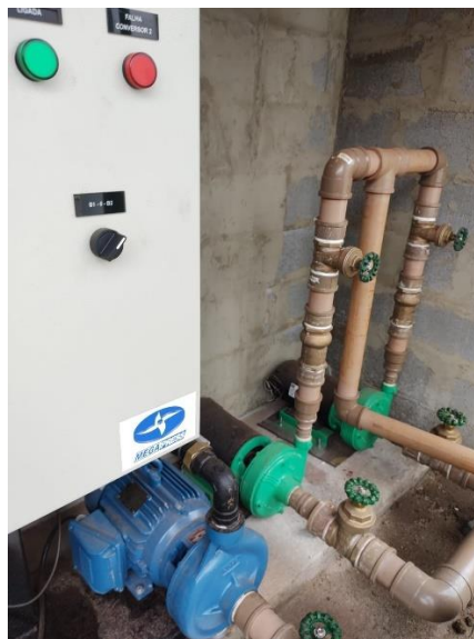
Figura 4: Conjunto de motobombas e boosters
