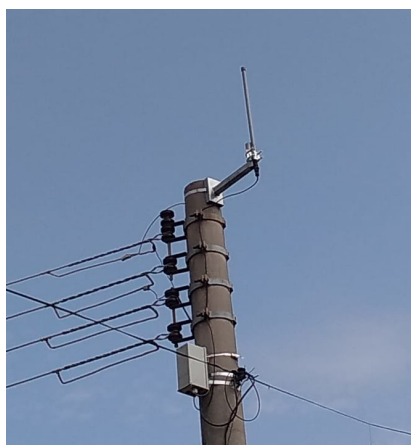
Figura 8 – Antena instalada no poste (08/2021)
