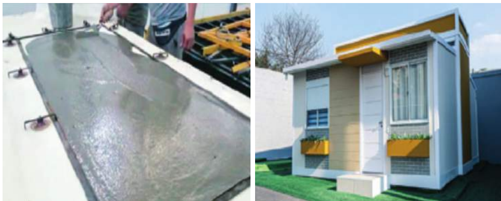
Figuras 2.11 – Projeto para utilização de CUADRF em casas pré-fabricadas: (a) aplicação do CUADRF para produção das placas (esquerda); (b) unidade habitacional confeccionada pela empresa (direita).
