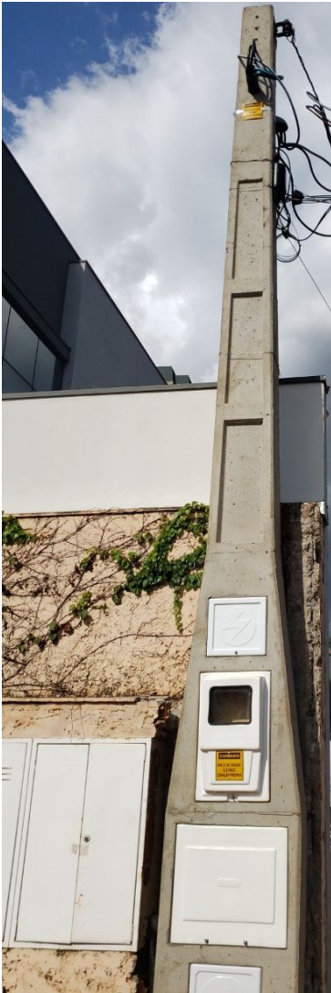
(a) Vista frontal do padrão de entrada aéreo com caixa de medição
