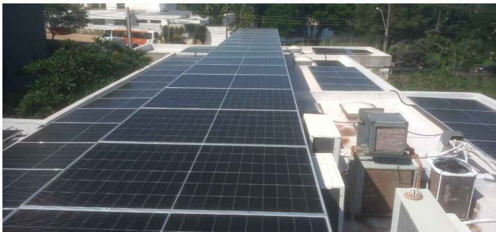
Figura 28 – Foto das placas fixadas em telhado (a)
