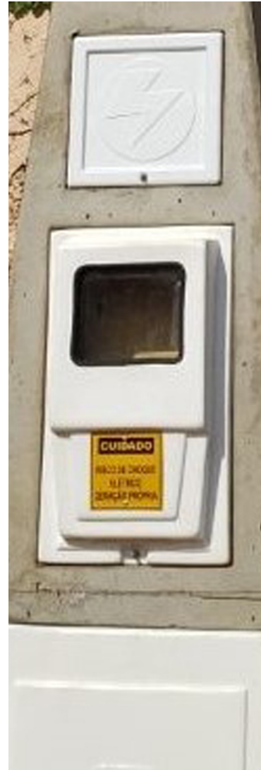
(c) Vista focada na placa de advertência fixada na caixa de medição
