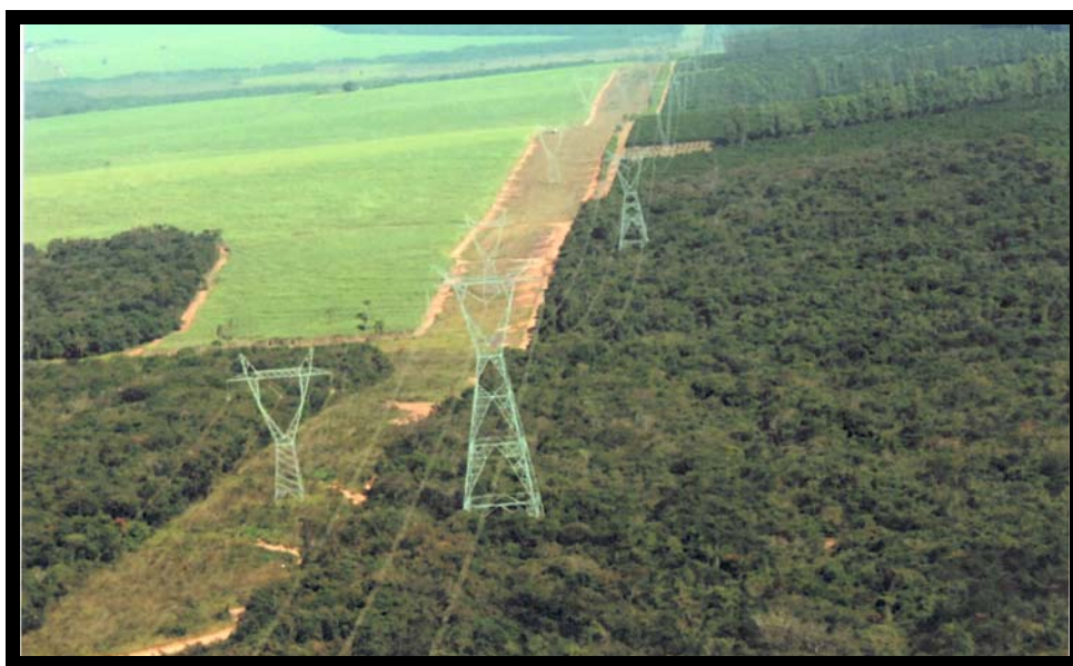
Figura 28. Fotografia aérea evidenciando a sequência de torres de transmissão autoportantes instaladas na Fazenda Pântano, bem como o paralelismo entre a LT Londrina (PR) – Araraquara (SP), sub-trecho Boa Esperança do Sul (SP) – Araraquara (SP), e a LT da Companhia de Transmissão de Energia Elétrica Paulista. Em detalhe as diferenças na supressão vegetacional entre as duas LT. Martins Filho, C. A. de S. (2008).
