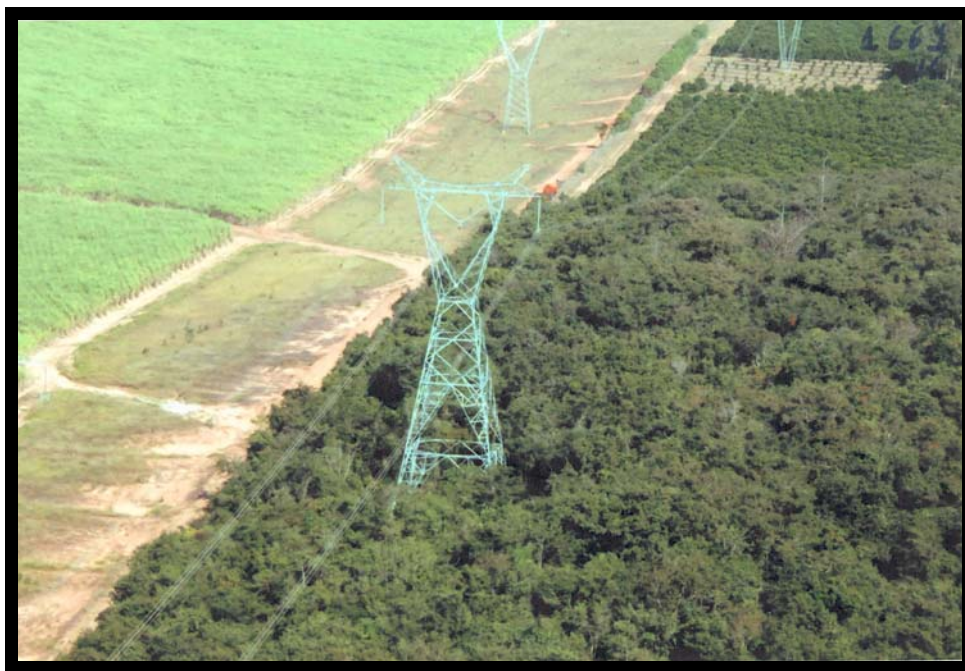
Figura 18. Fotografia aérea da torre de transmissão autoportante 203/2, localizada na Fazenda Paraíso. Martins Filho, C. A. de S. (2008).
