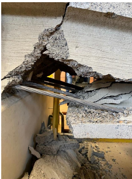
Figura 98: Ancoragem das armaduras após ruptura da laje – Laje B com capa e continuidade
