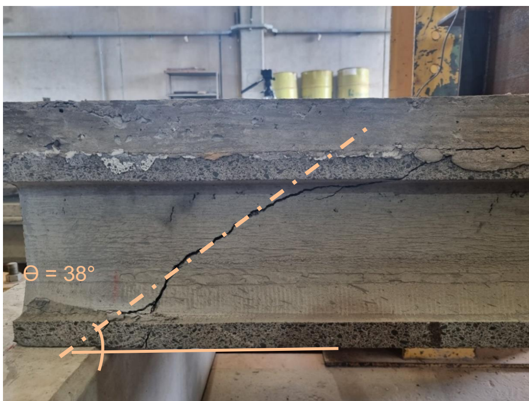
Figura 82: Fissura de ruptura – lado direito -laje com capa
