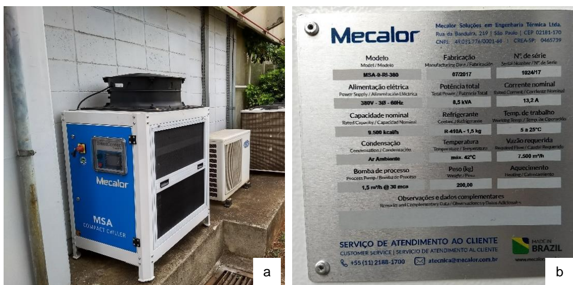
Figura 3.8 – a) foto do trocador de calor instalado para refrigerar a carcaça do forno, conforme especificação técnica do projeto e b) requisitos operacionais do equipamento, evidenciando capacidade nominal de troca térmica, condensação e temperatura de trabalho.
