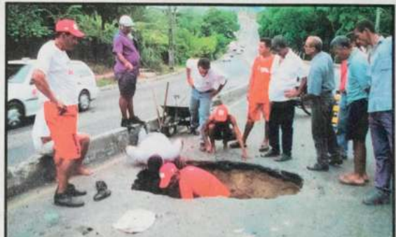
Buraco na galeria pluvial na avenida D. Pedro II será fechado em, no máximo, três dias. Página 5
