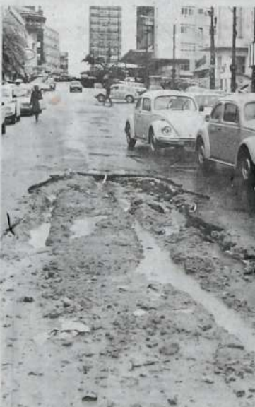
Na rua Padre Meira, a água abriu um enorme buraco
