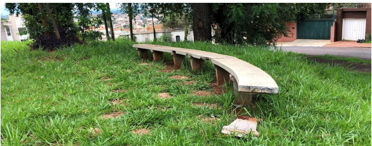
Figura 19 - Banco (mobiliário básico) deteriorado na Praça Antônio Lopes Velludo (EL 4.B)
