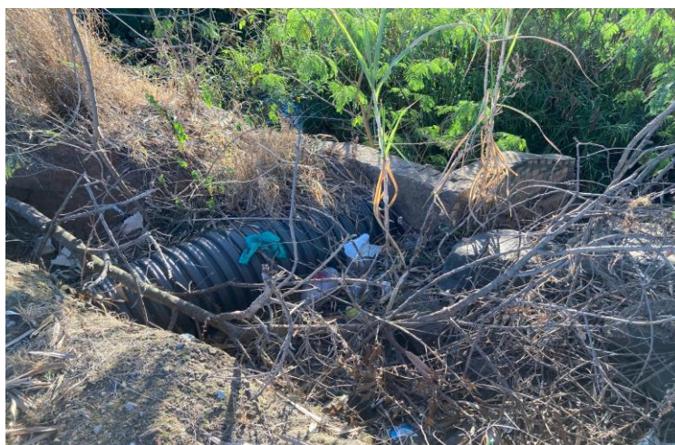
Figura 35: Erosão em obra pluvial no Córrego do Serralha.
