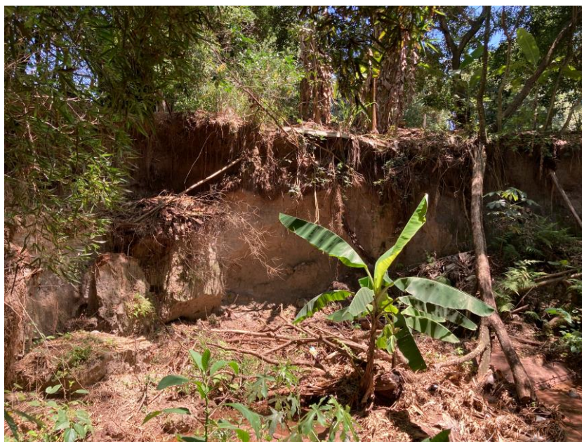
Figura 32: Processo erosivo na margem no Córrego do Serralha.
