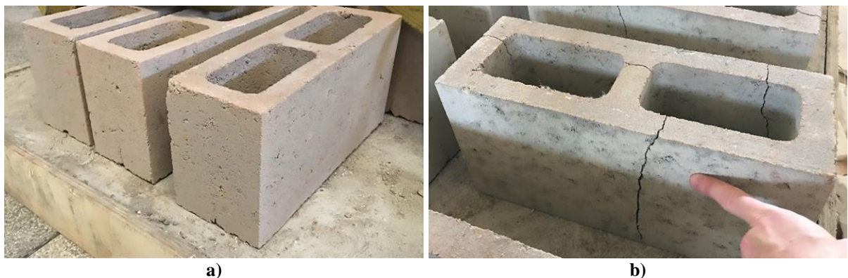
Figura 2.36 – Condição dos blocos de concreto após o aquecimento: a) blocos de 4 MPa; b) blocos 10 MPa.
