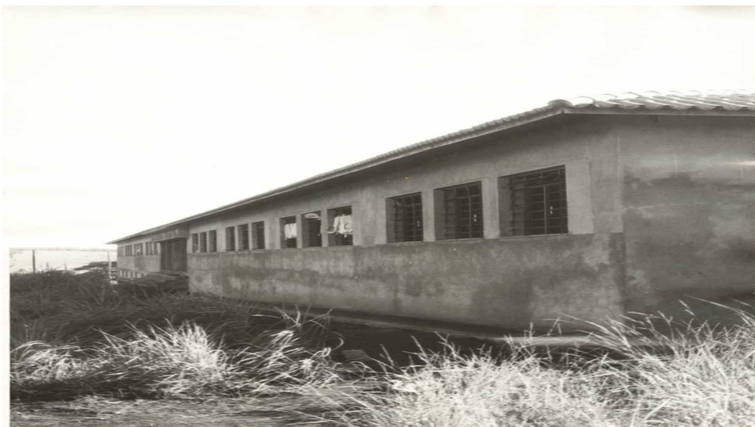
Figura 66 – Vista parcial das obras paralisadas do prédio principal do Colégio Agrícola (1964)
