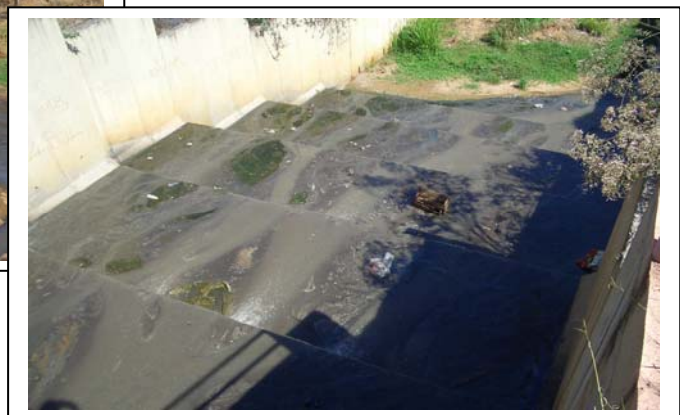
Figura 5. Descarga de esgoto
